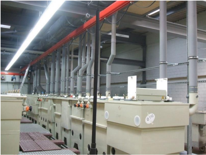
Galvanik – Badanlage bestehend aus verschiedenen PP – Wannen. Mit Abluftkanälen und allen nötigen Verrohrungen
