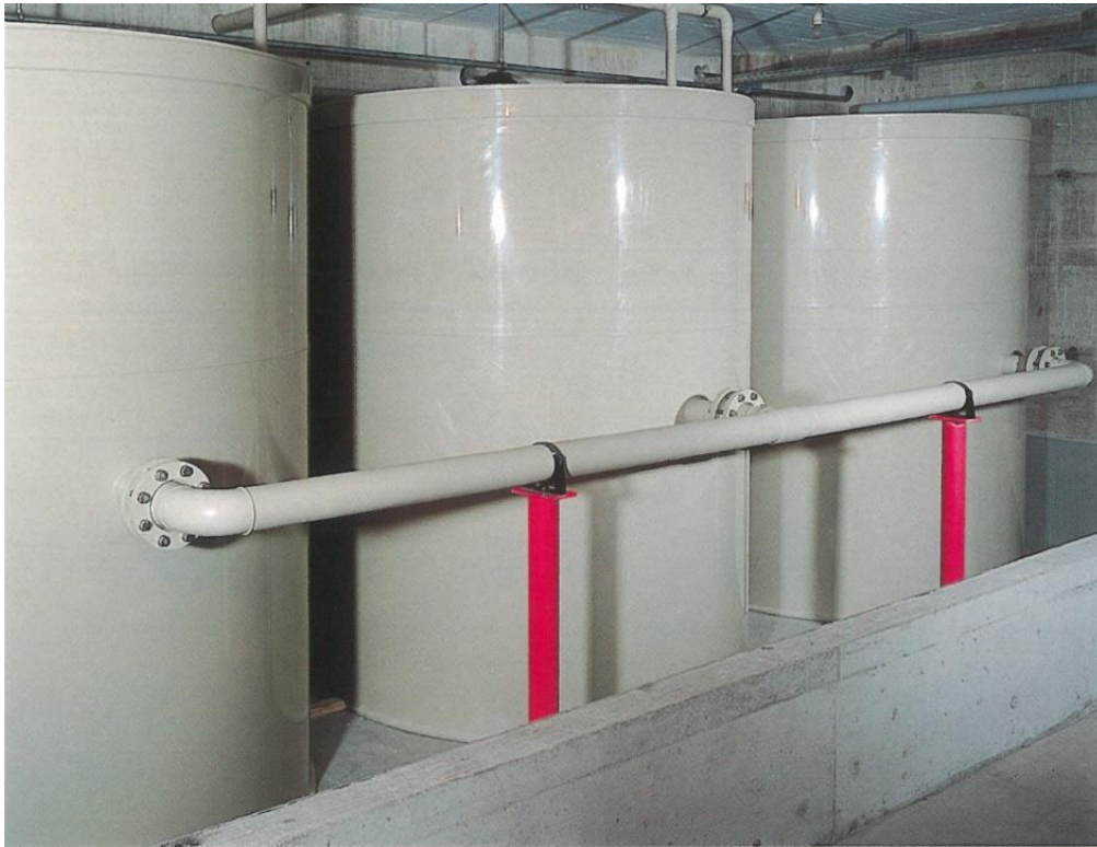
Stapeltanks aus PP (Polypropylen), Inhalt 6'800 l je Tank, Medium: Abwasser
