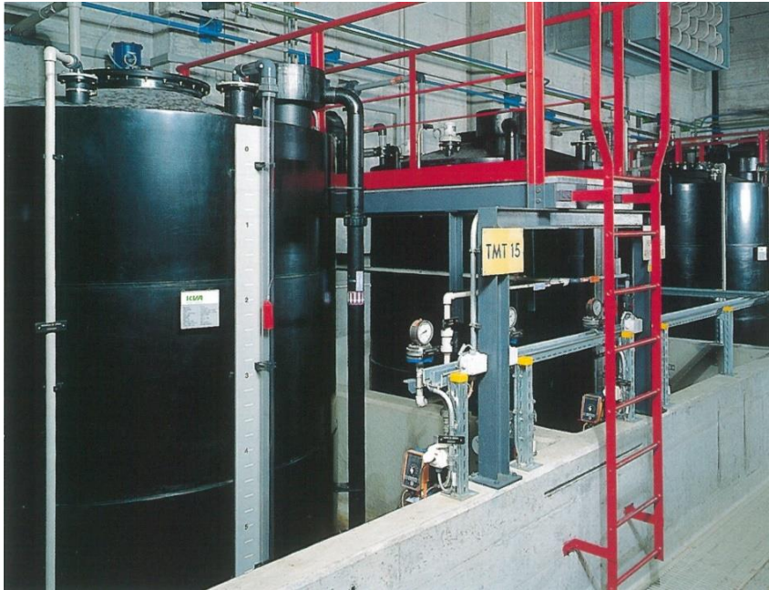
Tankanlage, bestehend aus 3 individuell konzipierten Einzeltanks (6'900 l) aus PE inkl. Verrohrung. Medien: Wasserstoffperoxid, Eisenchlorid und Salzsäure
