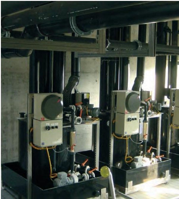
Abluftwäscher aus PE-EL mit PE-EL Zu-/ und Abluftrohrleitungen
