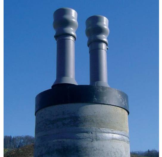
PE - Deponieschachtabdeckung mit Durchführung von PPs Abluftrohren
